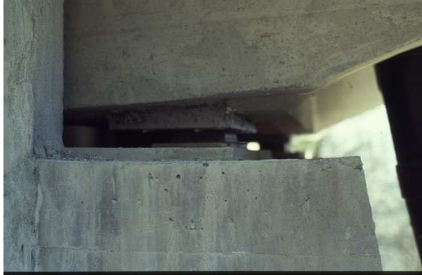
Abb. 38 Gleitlager, Salignatobel-Brücke, Schweiz
